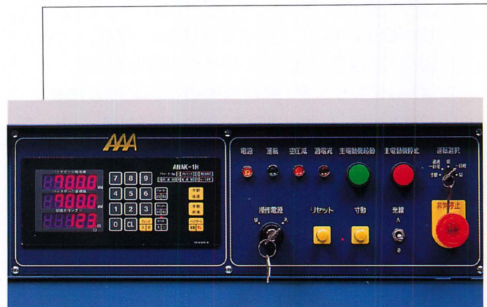
集中操作盤 Control panel
