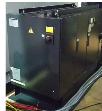
システム制御装置
